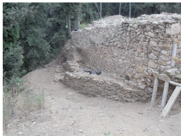
Fig 4.7.6. Tram final de la muralla 3330. El mur esllavissat (3441) va ser reparat però es va bastir un xic enrere (3440).
